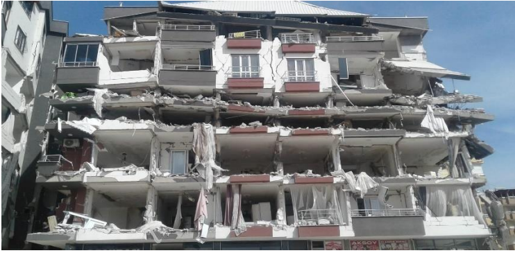
Resim 6- Deprem sonucu ağır hasar almış bir apartman
